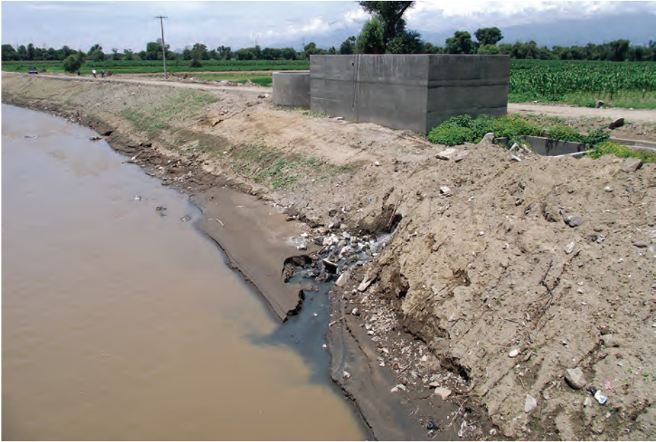
Fotografía 19. Río Atoyac durante época de lluvias, vista desde el puente de San Rafael Tenanyecac. El desagüe domiciliario donde claramente puede distinguirse el tinte color índigo procedente de alguna o algunas lavanderías de mezcilla.
