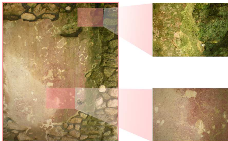
Ilustración 15: Repellado donde se observa una sección donde había escurrimientos continuos de agua. Arriba, detalle de microorganismos; abajo, detalle de sales en superficie. Edificio norte, Pequeña Acrópolis. Fotografías: Luisa Straulino.
