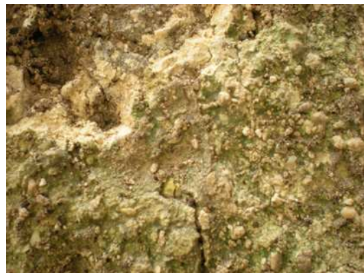
Ilustración 14: Repellado con biofilm ocasionado por escurrimiento. Estuco interior del edificio central, Pequeña Acrópolis. Fotografía: Luisa Straulino
