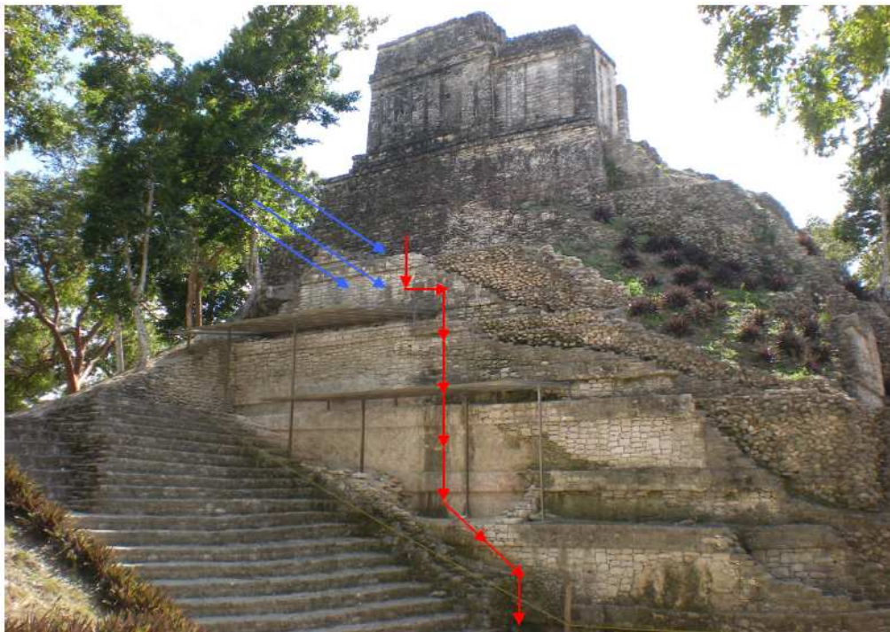
Ilustración 21: Trayecto de escurrimiento de agua en el basamento por colocación deficiente del techado.
