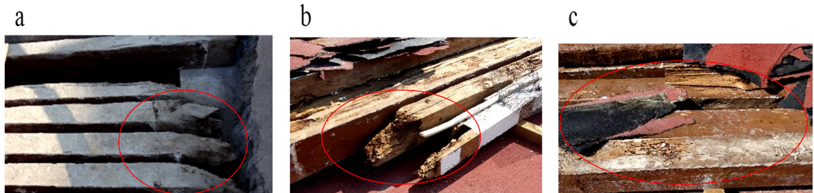
Figura 11. 5. Condiciones de las cabezas de las vigas de la Catedral Metropolitana de Morelia (a, vigería sin terrado, b y c vigería retirada).
