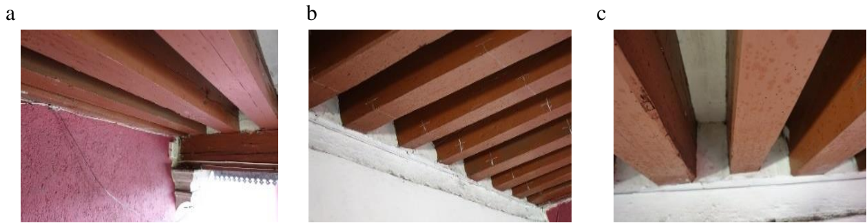
Figura 10. 7. Vista de las condiciones de los elementos que conforman el Pasillo 3.
