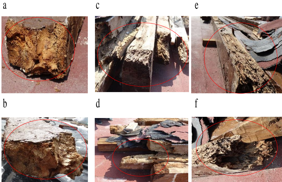
Figura 11. 6. Condiciones de las cabezas de las vigas de la Catedral Metropolitana de Morelia (b, c, d, e y f vigería con posibilidades de ser reutilizada, a y b madera en pésimas condiciones fracturada al ser retirada).
