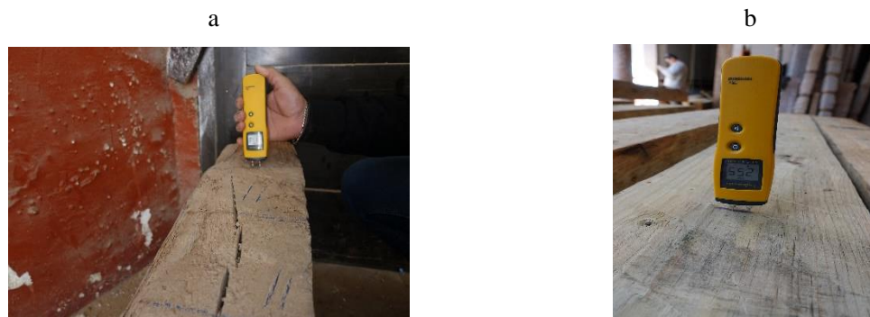
Figura 12. 18. Mediciones del % de humedad en la vigería deteriorada (a) y en la vigería sana (b).
