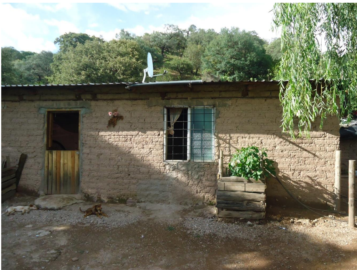
Imagen 12. Vivienda de la localidad de El Kípor. En ella se puede apreciar el tipo de construcción típico de la región serrana.
