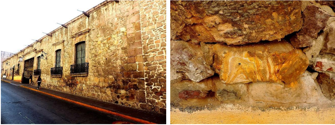
Fig. 13. Estado actual de la ignimbrita en fachada principal de inmueble ubicado en la calle Guillermo Prieto, Colonia Centro, Morelia, Michoacán, México. Fuente: Aldo Zamudio Pérez, 2015.
