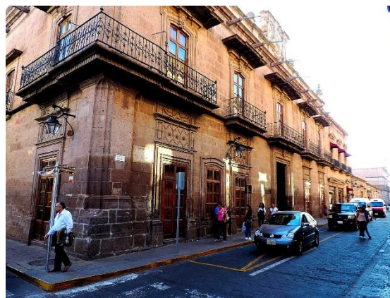
Figura 13: Altura de humedad en inmueble de calle Allende, Morelia, Michoacán, México. Fuente Aldo Zamudio Pérez, 2017.
