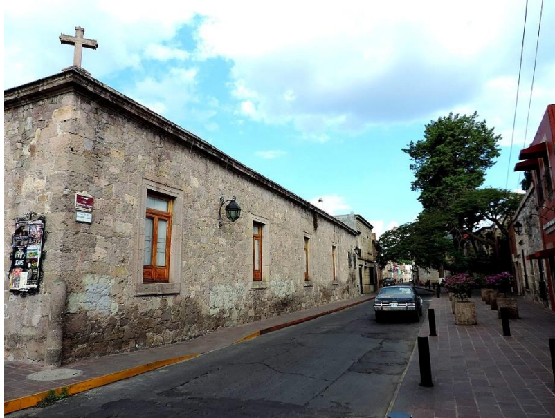
Fig. 33. Humedad por capilaridad en mamposterías de calle Bartolomé de las Casas en Morelia Michoacán. Fuente Aldo Zamudio Pérez, 2017.
