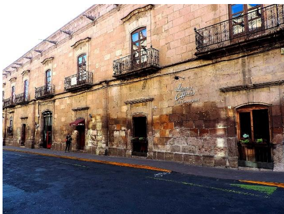
Figura 12: Altura de humedad en inmueble de calle Galeana, Morelia, Michoacán, México. Fuente Aldo Zamudio Pérez, 2017.
