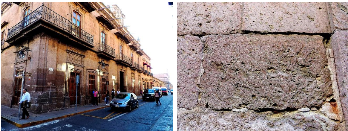
Fig. 15. Estado actual de la ignimbrita en fachada principal de inmueble ubicado en la calle Allende, Colonia Centro, Morelia, Michoacán, México. Fuente: Aldo Zamudio Pérez, 2015.
