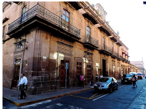
Fig. 17. Humedad constante de la ignimbrita en fachada principal de inmueble ubicado en calle Allende, Colonia Centro, Morelia, Michoacán, México. Fuente Aldo Zamudio Pérez, 2015.
