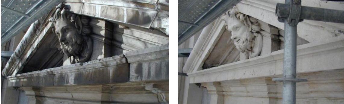
Fig. 09. Alteración de la superficie pétreo por contaminación antrópica. Imagen izquierda con deterioro, imagen a la derecha después del proceso de restauración. Fuente: Enrique Salgado, Restauración del Palacio Real de Madrid, [28 de marzo de 2017], http://www.esalgado.es/restauracion-del-palacio-real-de-madrid .
