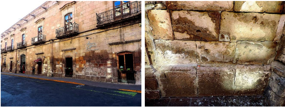
Fig. 14. Estado actual de la ignimbrita en fachada principal de inmueble ubicado en la calle Galeana, Colonia Centro, Morelia, Michoacán, México. Fuente: Aldo Zamudio Pérez, 2015.
