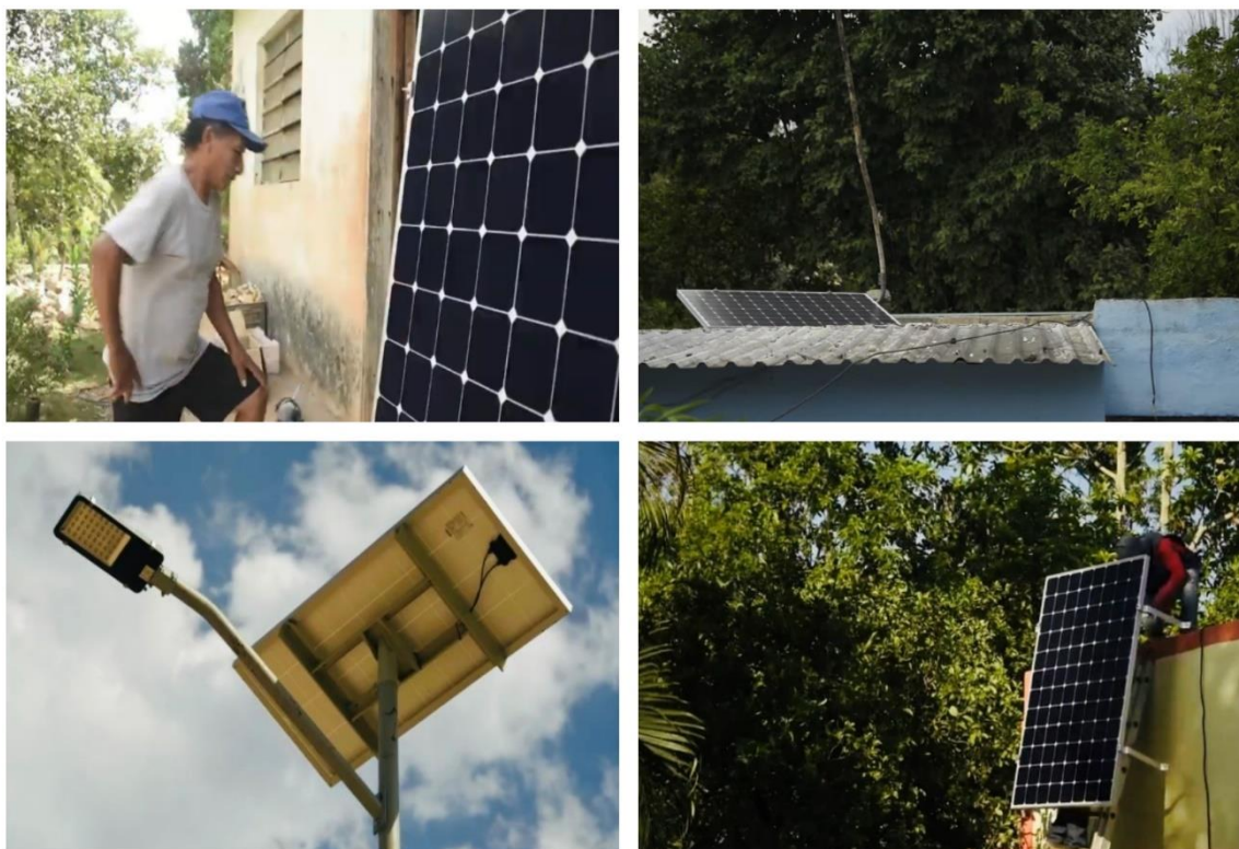
Figura 8: Instalación de sistemas fotovoltaicos en la población de San José como parte del proyecto de corresponsabilidad social entre Iluméxico y Vega Solar. Fuente: Vídeo Iluméxico-Vega Solar, https://youtu.be/CuRgfyzXvTM
