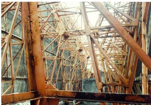
Figura 6. Estructura metálica que soportaba los paneles de asbesto-cemento del Mural N°3 exterior de La Tallera (1964-1965). Fotografía del Archivo interno del CENCROPAM-INBA
