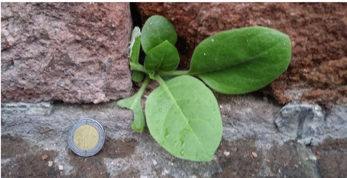
Figura 38. Plantas pequeñas, como en este caso, y árboles pueden generar daños debido al crecimiento de sus raíces. Centro Histórico de San Luis Potosí.
