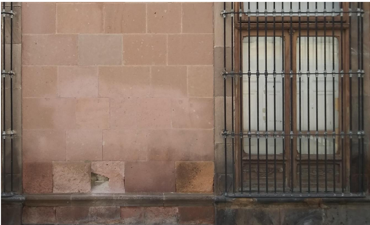
Figura 28. Daño de origen mecánico causado por abrasión (zona con un color más claro). Más abajo se distingue otro tipo de daño denominado faltante. Centro Histórico de San Luis Potosí.
