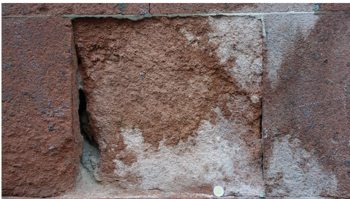
Figura 31. Crecimiento de cristales de sal en la superficie de las rocas, lo que se conoce como eflorescencia. Centro Histórico de San Luis Potosí.
