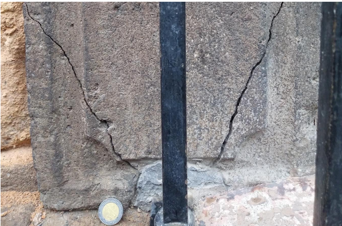
Figura 22. Fisuración radial del bloque de roca como respuesta a la presión ejercida por la oxidación del anclaje de hierro de la ventana. Centro Histórico de San Luis Potosí.
