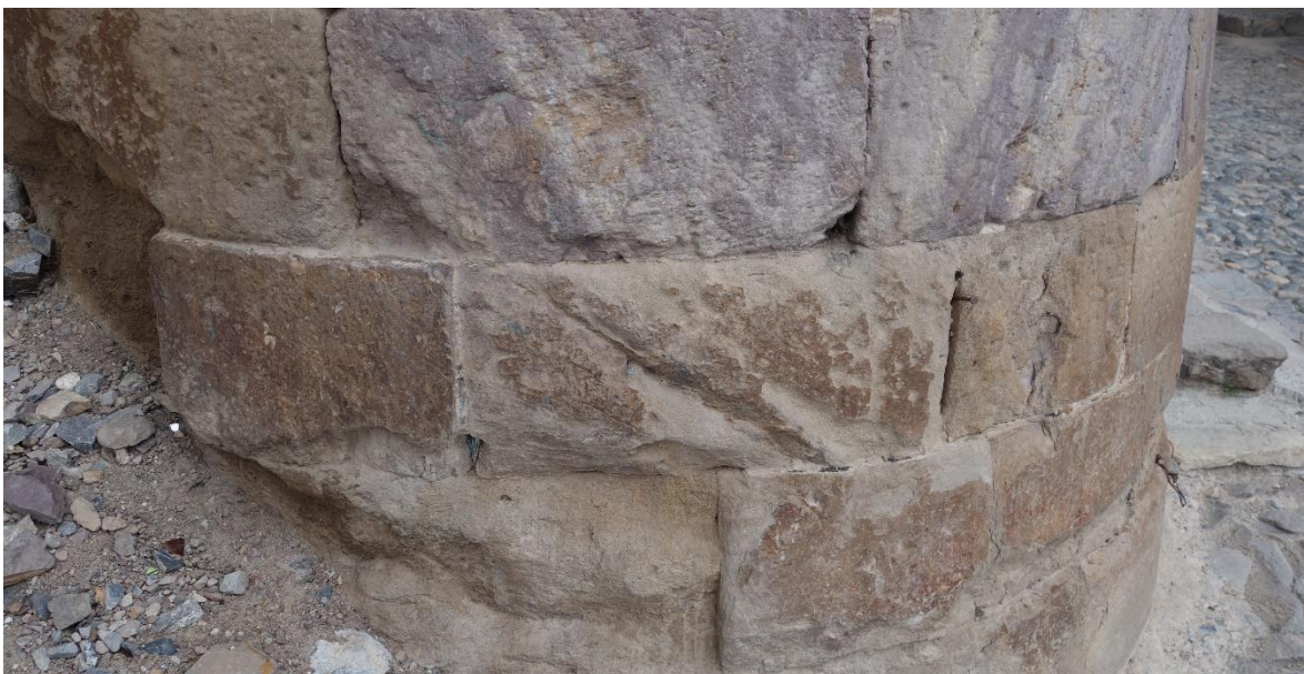
Figura 33. Pátina ferruginosa desarrollada en algunos bloques de arenisca. La apariencia color marrón oscuro permite identificarla claramente. Muro de la antigua alhóndiga en Real de Catorce.
