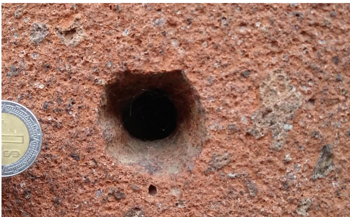
Figura 29. Perforación. Si bien puede tratarse de un daño de origen mecánico, no se le considera como un subtipo de esta categoría debido a que también puede ser resultado de la acción de un animal. Centro Histórico de San Luis Potosí.
