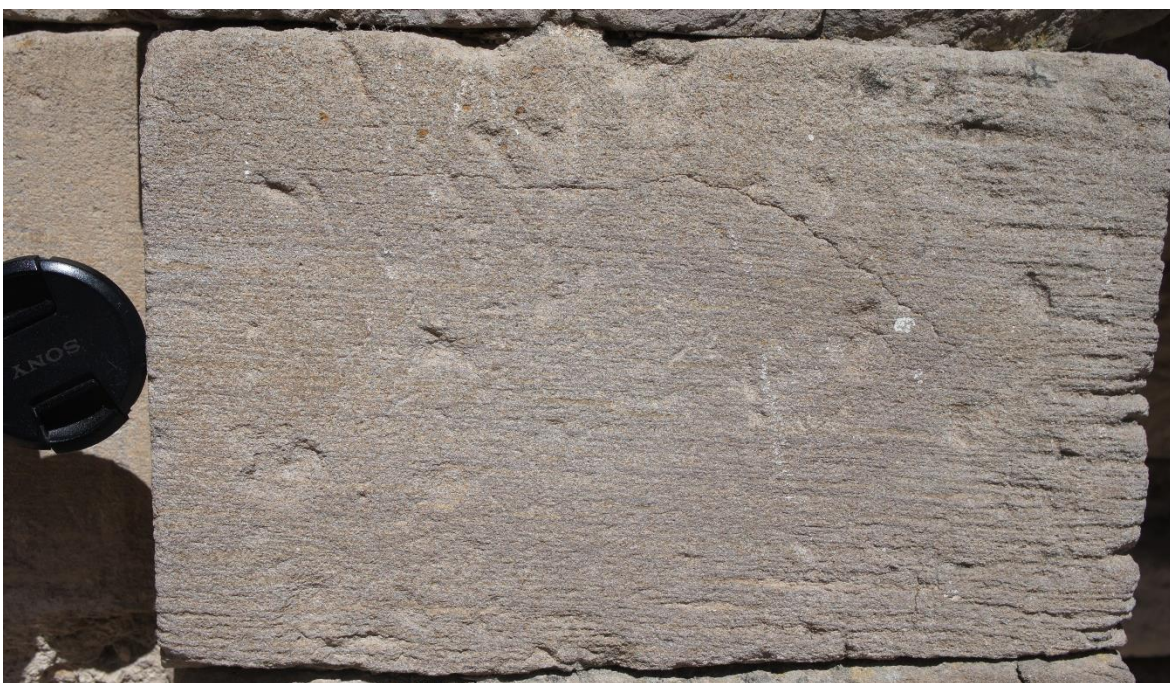
Figura 24. Daño de deslaminación caracterizado por la separación de las láminas. Centro Cultural de Real de Catorce.
