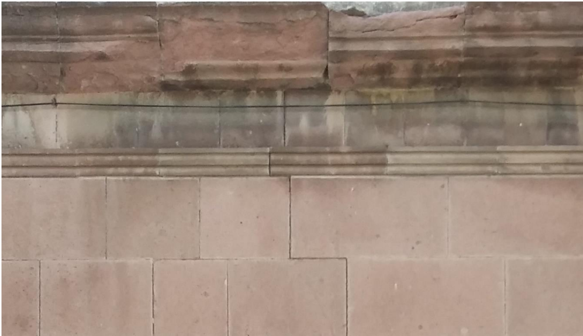
Figura 34. Enmugrecimiento que se observa como material oscuro que probablemente está compuesto por partículas depositadas por la escorrentía de agua de lluvia. Centro Histórico de San Luis Potosí.
