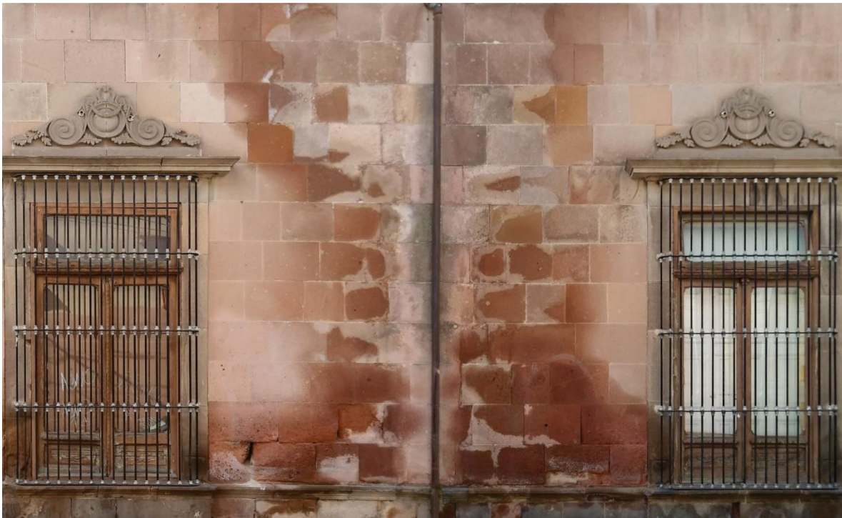
Figura 30. Manchas de humedad creadas alrededor de una bajada de agua, indicando una posible fuga. Centro Histórico de San Luis Potosí.
