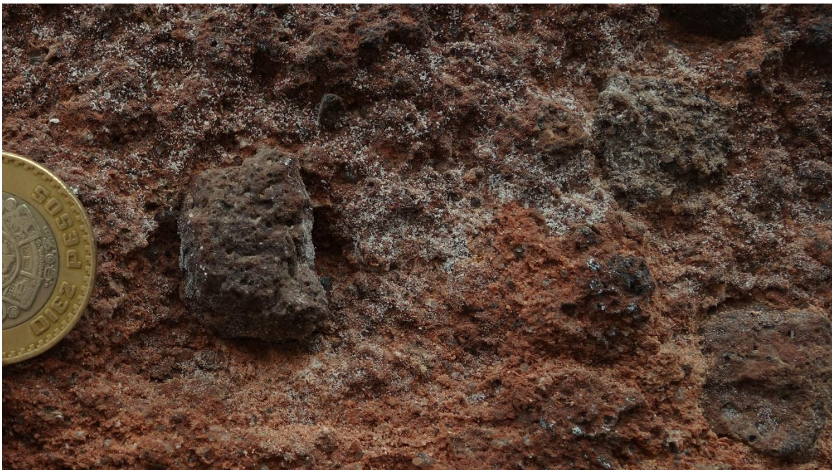
Figura 27. Erosión diferencial por pérdida de matriz alrededor de un fragmento volcánico. Centro Histórico de San Luis Potosí.
