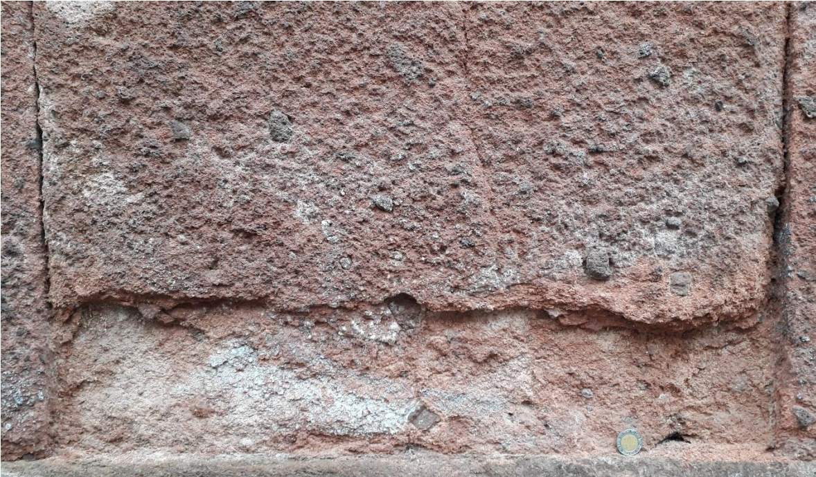
Figura 35. Subflorescencia en la parte inferior del bloque. La identificación de este daño es posible debido al desprendimiento de la superficie de la roca. Centro Histórico de San Luis Potosí.
