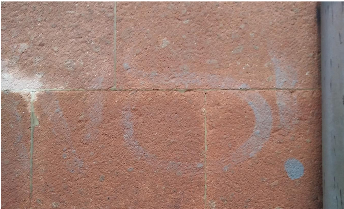
Figura 32. Daño por graffiti . Existen algunos graffitis que, debido a su importancia histórica, no necesariamente se consideran como daños. Centro Histórico de San Luis Potosí.
