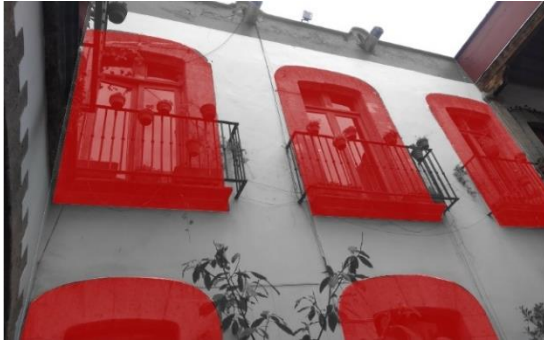
Imagen LXXIV. Enmarcamientos independientes del patio principal de la casa Tlaxcala. Fuente: elaboración propia a partir de fotografía de RGM.
