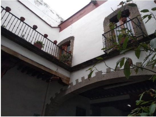
Imagen XXXV. Corredores de la Casa Tlaxcala. A la izquierda el corredor de comunicación sobre el muro de colindancia, a la derecha el "corredor" habitable, probablemente sirviera como gabinete. Fuente: fotografía RGM.
