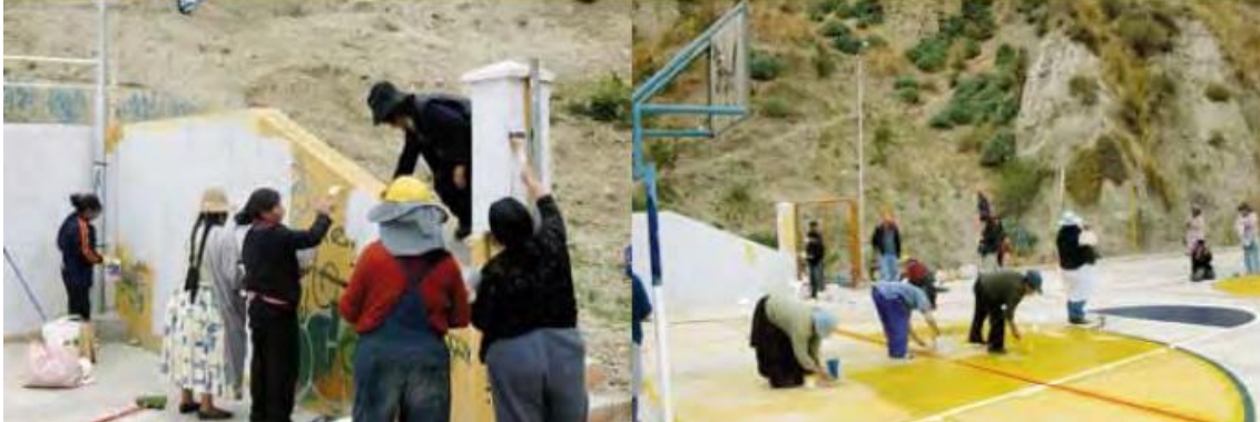
Primeras actividades de las mujeres constructoras previas a la conformación de las micro empresas - Mejoramiento de la cancha del barrio Pacasa.
